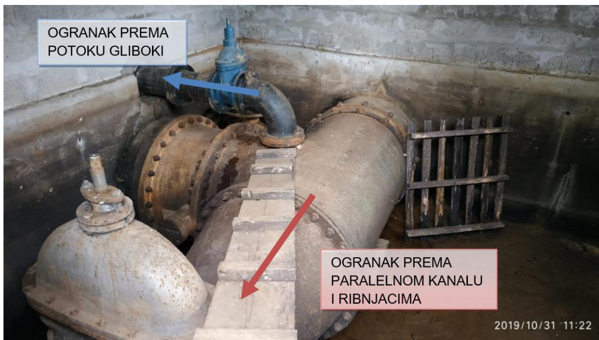
Fotografija 3-5: Zasunska komora
