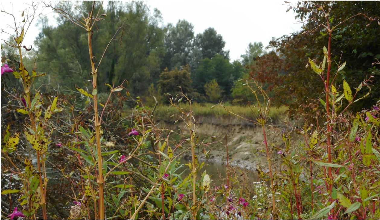
Slika 4. Predmetna erodirana obala u rujnu 2019.
