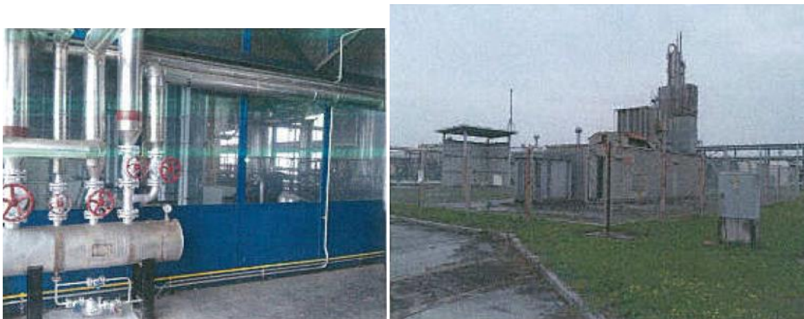
Slika 4.2.2. Razdjelnik pare na CPS II (a) i mjesto ugradnje nove turbine (b)
