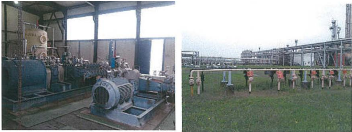
Slika 4.2.8. Pumpaonica slojne vode – zamjena pumpi (a) i Kolektor slojne vode (b)
