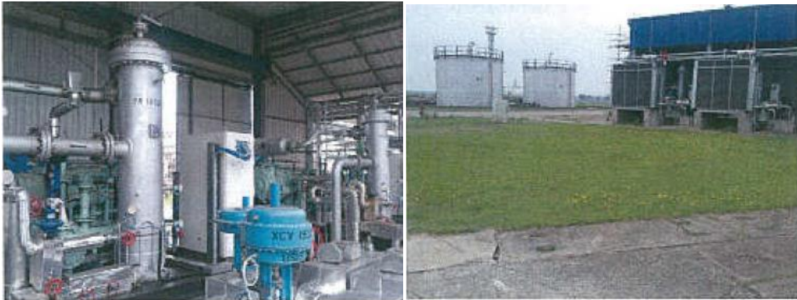
Slika 4.2.3. Postojeća kompresornica na CPS Molve I (10-55 bar) (a) i mjesto ugradnje novih kompresora (1 -10 bar) (b)
