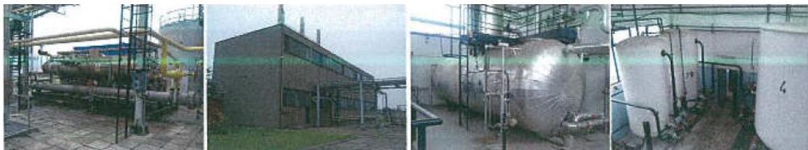
Slika 4.2.4. Rashladno postrojenje „Fric“ (a), kotlovnica (b), termička priprema vode (c) i kemijska priprema vode (d)
