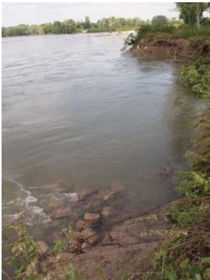
Slika 2. Fotografija na kojoj je vidljiva erozija i ostaci obaloutvrde
