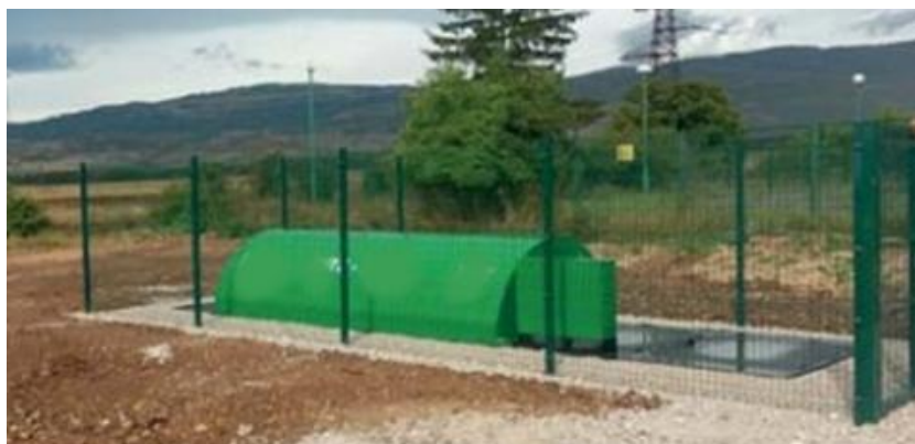
Slika 3.5. Uređaj za pročišćavanje otpadnih voda
