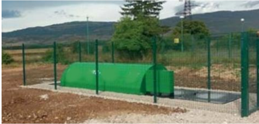
Slika 3.6. Uređaj za pročišćavanje otpadnih voda
